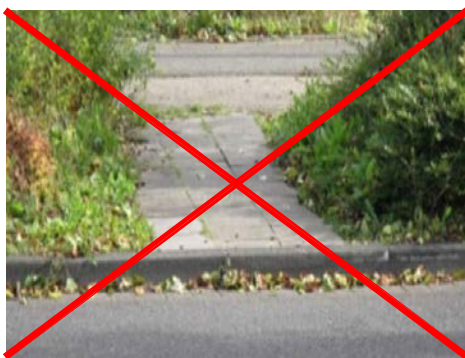
Absenkung über drei Zentimeter
